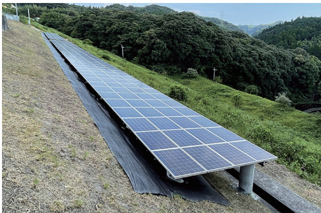
2021年8月6日より電力供給を開始した やまとソーラープラント細田口 [鹿児島市五ヶ別府町 発電量49.5kW]
